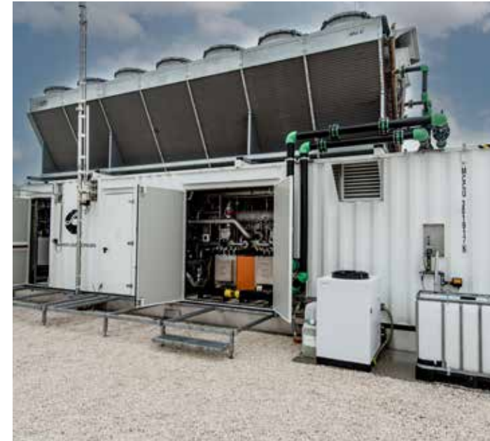
2 MW Wasser-Elektrolyse in Rubensdorf
